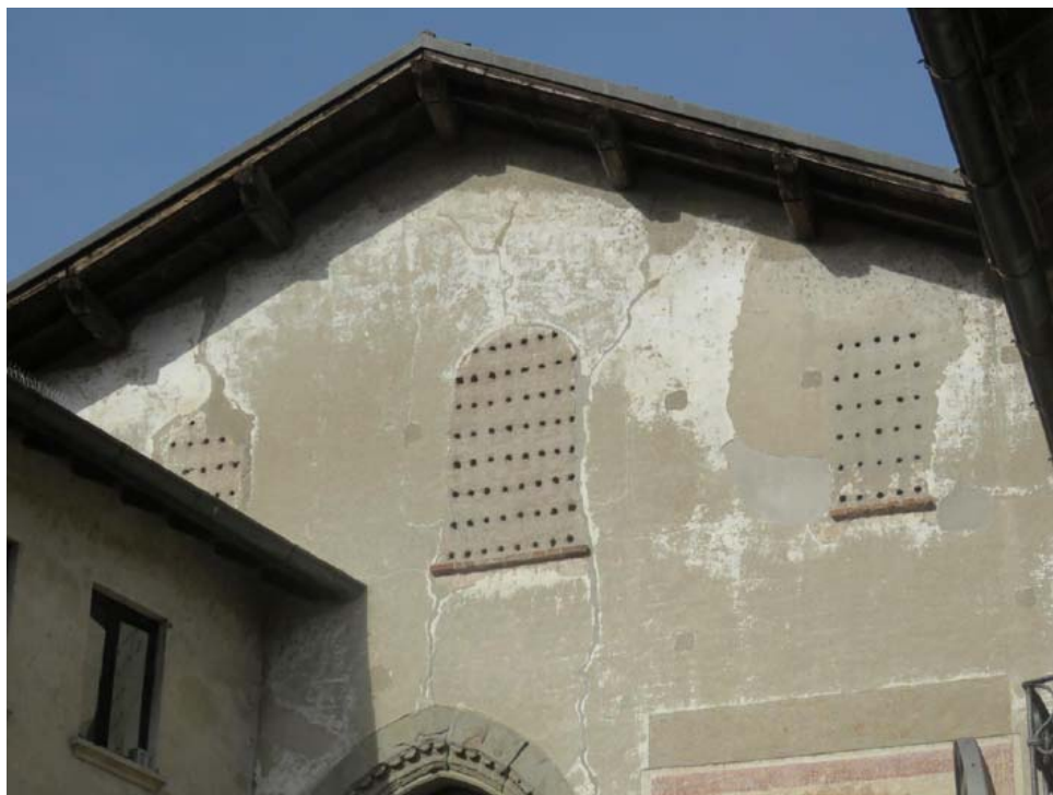
Figura 5 - Tipiche strutture per passeri o storni inserite nella parete, probabilmente ricavate dalla successiva tamponatura di finestre preesistenti; attualmente non utilizzata. Palazzo Branda Castiglioni XIV - XV secolo – Castiglione Olona (VA). © Lorenzo Colombo
